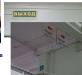
Информационные знаки на путях эвакуации
